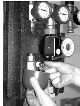
Point 7 : séparateur d'air
