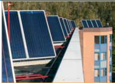
Installation solaire de la résidence "Jours heureux" à Eghezée réalisée en collaboration avec les Ets Laurent (Cognelée)
